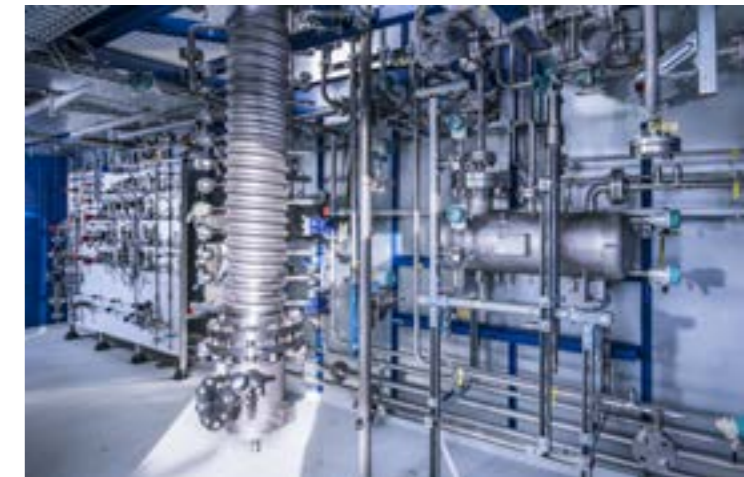
Blick in die Containeranlage zur Dreiphasen-Methanisierung. Foto: Amadeus Bramsiepe/KIT
