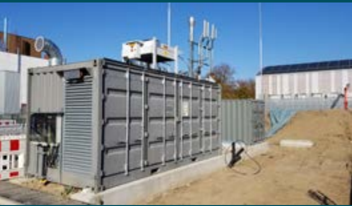
Eine drucklose Festoxidzell-Wasserdampfelektrolyse mit einer Leistung von 150 kW, die sich auch im Brennstoffzellenmodus betreiben lässt, im Energy Lab am Campus Nord des KIT. Foto: KIT
