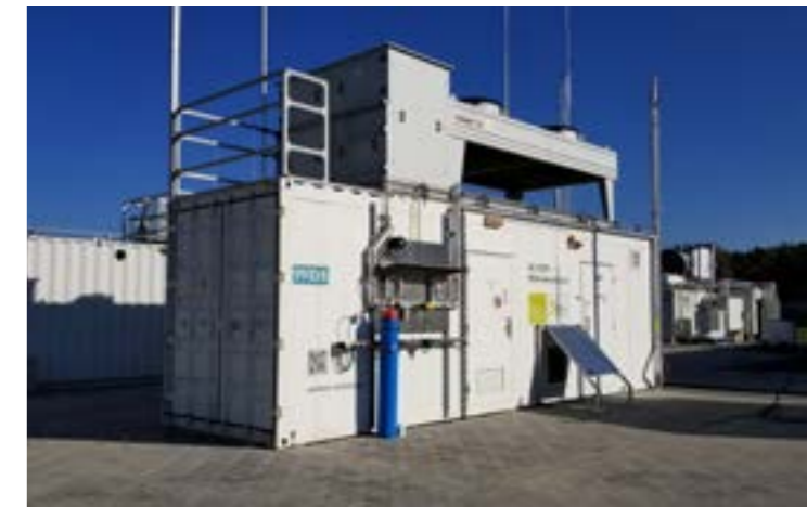
Der Silyzer 100 von Siemens Energy, ein druckbetriebener PEM-Wasserelektrolyseur, im Energy Lab des KIT. Foto: IMVT/KIT
